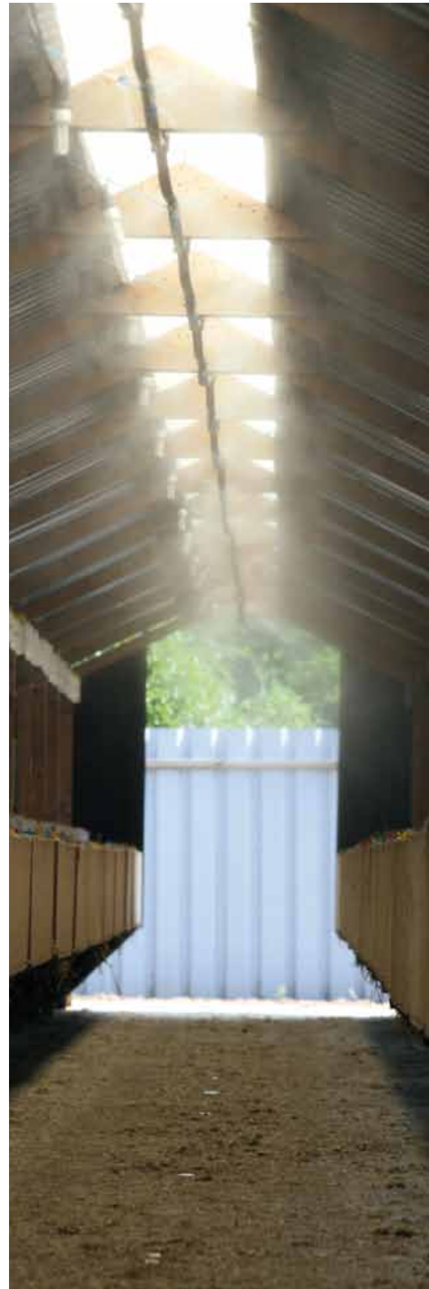
Nevelinstallatie in werking
